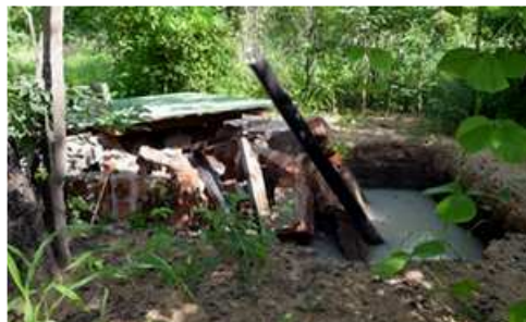
Die eingestürzte Toilette
